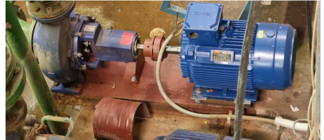
Bereits in Stand gesetzte Pumpe mit Motor
