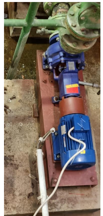
Bereits in Stand gesetzte Pumpe mit Motor
