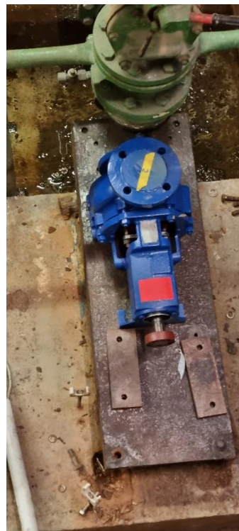
Pumpengehäuse vorbereitet für Motor
