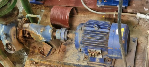
Pumpe mit Wasserschaden
